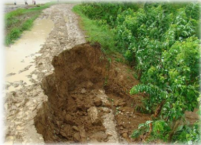
Deslizamientos en viales
